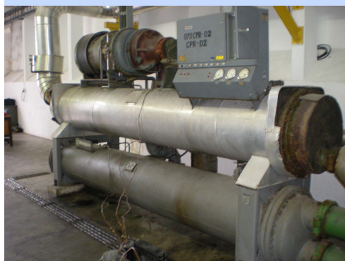
Substituição do R-12 pelo ISCEON™39TC na centrífuga Westinghouse.
